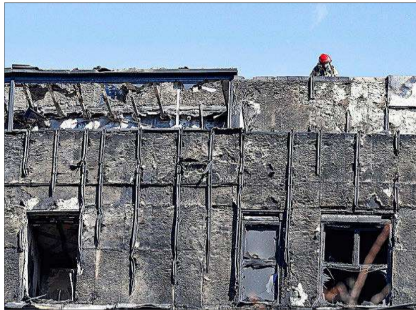
Un bombero, en la azotea del edificio siniestrado. DAVID GONZÁLEZ / ARABA PRESS
